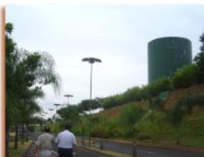
TANQUE DE ÁGUA GELADA DE 1.300.000 LITROS EQUIVALENTE A 230TR
